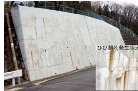
(a) 施工前のひび割れ発生状況
